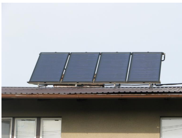
Ryc. 9. Przykład instalacji słonecznej zamontowanej na dachu domu w Kwilczu (fot. H. Łożyńska).
