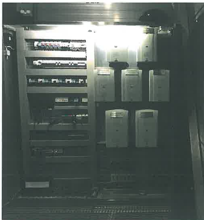
Rozdzielnia główna SUW
