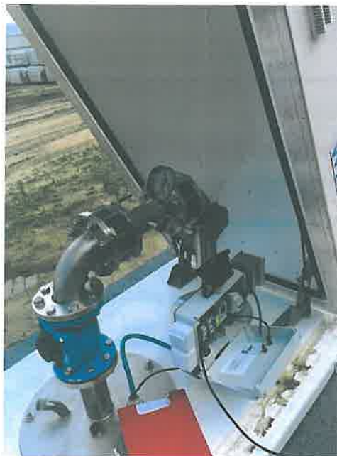
Pomiar studni głębinowych.
